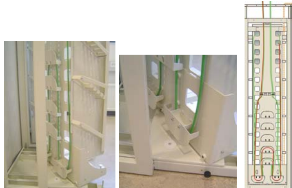
Kabeldragning på stativets baksida
