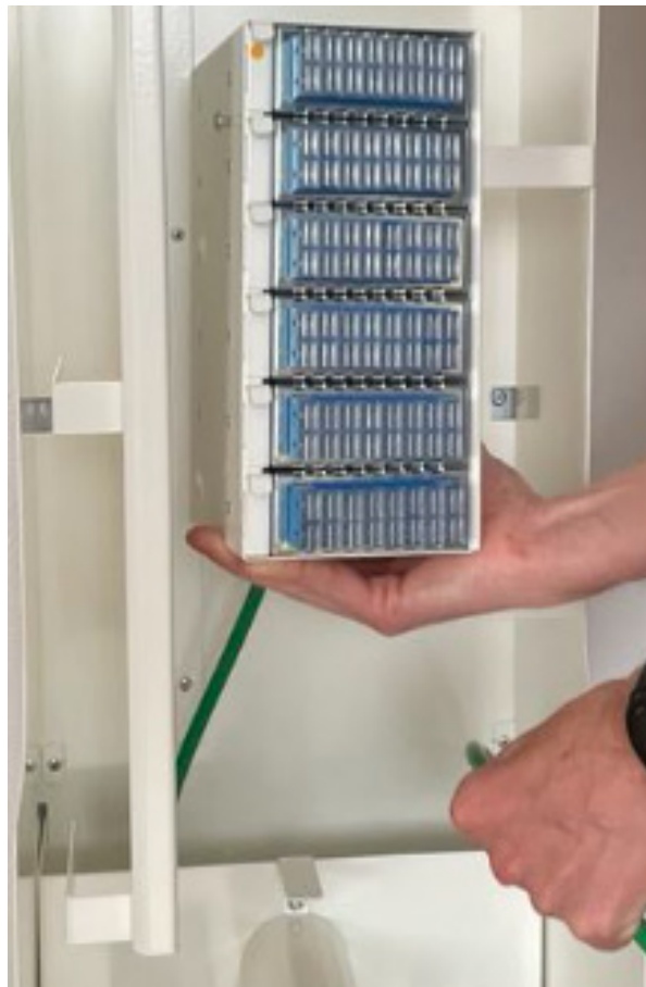
ODF-box med grön kabel
